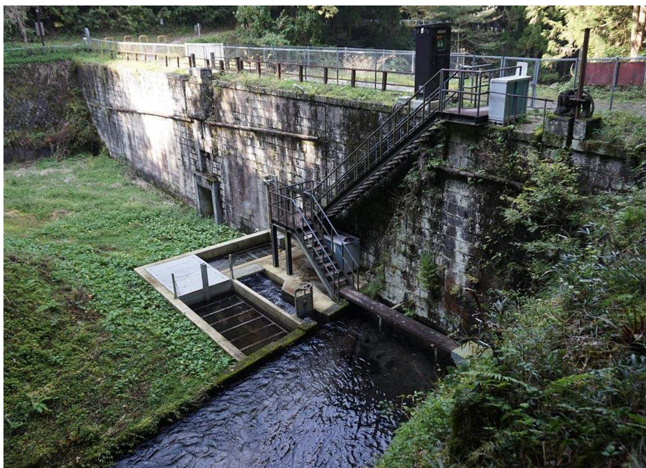
写真 3◇湧水口の直下に造られたロックフィル・ダム。階段の真下にある設備が新設の取水口
