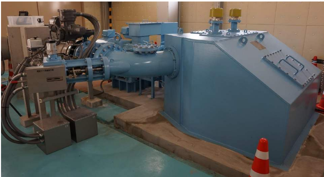
写真 6◇水車発電機（青い装置全体）。右側の黄色いバルブの付いたボックスの中にターゴ水車を格納
