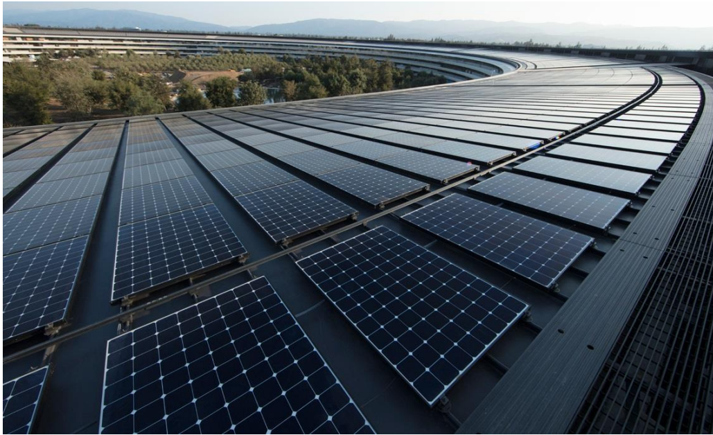
写真 2. 本社ビルの屋上に設置した太陽光パネル。出典：Apple
