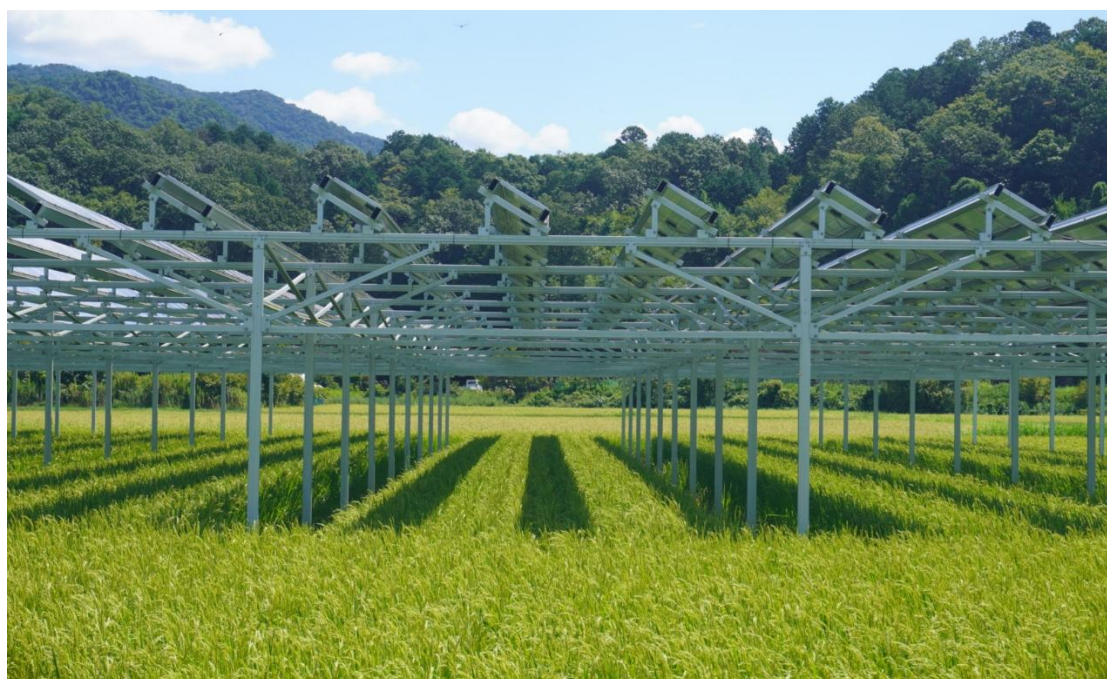
写真 2◇水田の上に設置した太陽光パネル(5 号機)
