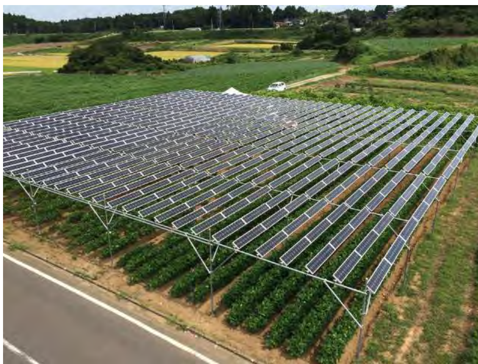
写真1-1 「匝瑳第一市民発電所」の全景
