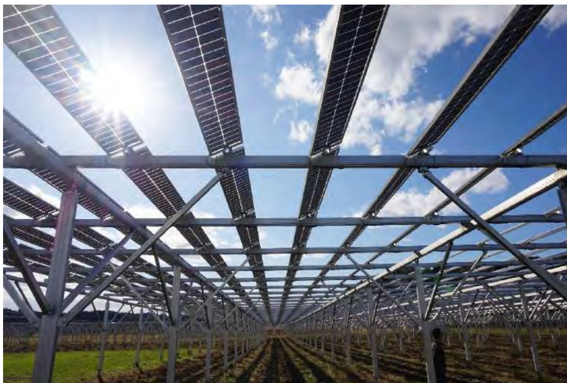
写真 1-6 太陽光パネルの設置状況
