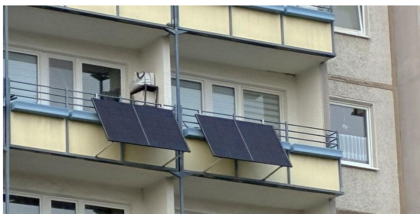
図 1：集合住宅のバルコニーに設置されたプラグインソーラーの例
