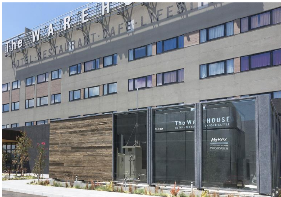
写真 4. 「川崎キングスカイフロント東急 REI ホテル」に設置した燃料電池 出典：東芝エネルギーシステムズ
