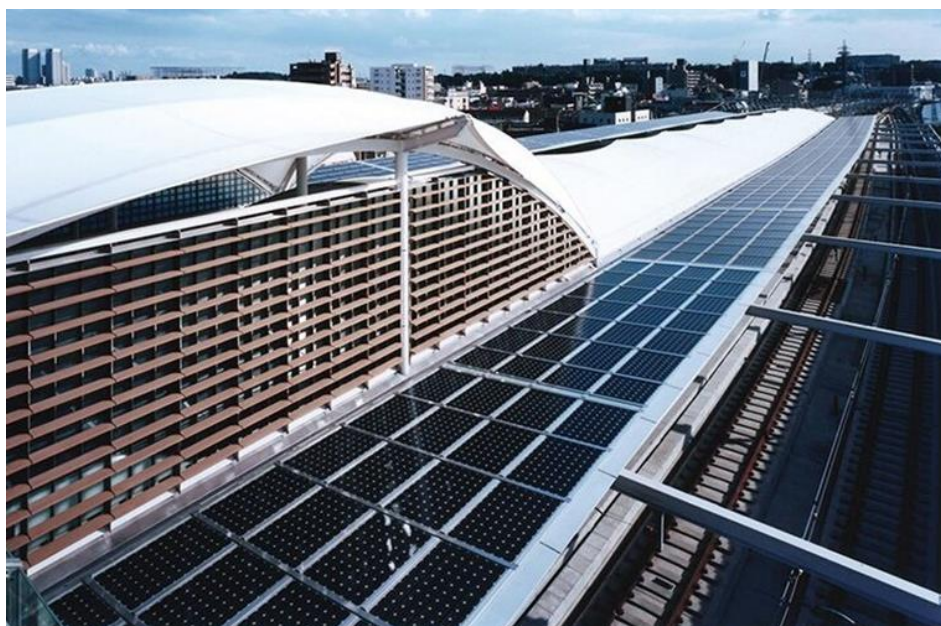
写真 3. 駅の屋根に設置した太陽光パネル（神奈川県川崎市の元住吉駅）
