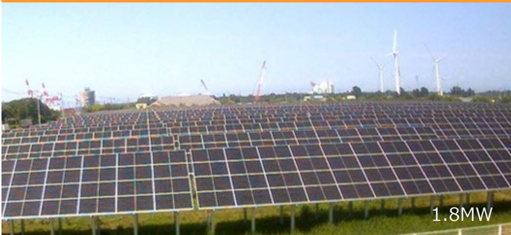
KCCS 太陽光発電所
