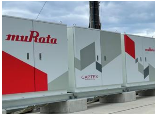
内製セルを使った蓄電システム
