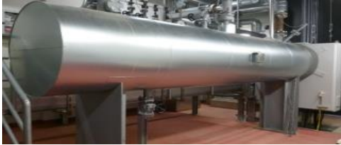
Power to Heat Stadtwerke Schwerin
