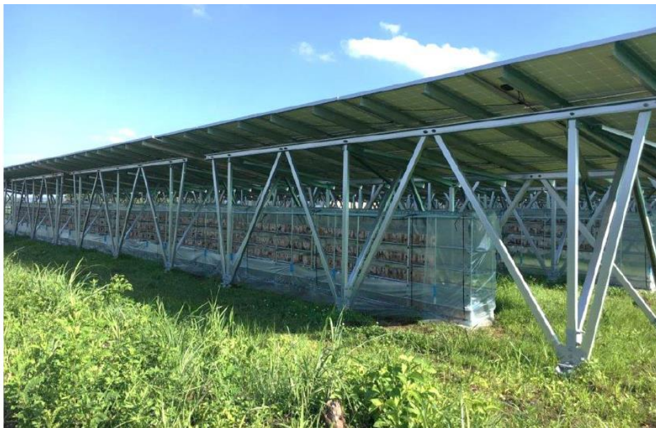
写真7◇「加美八幡堂太陽光発電所」の架台。出典：サステナジー
