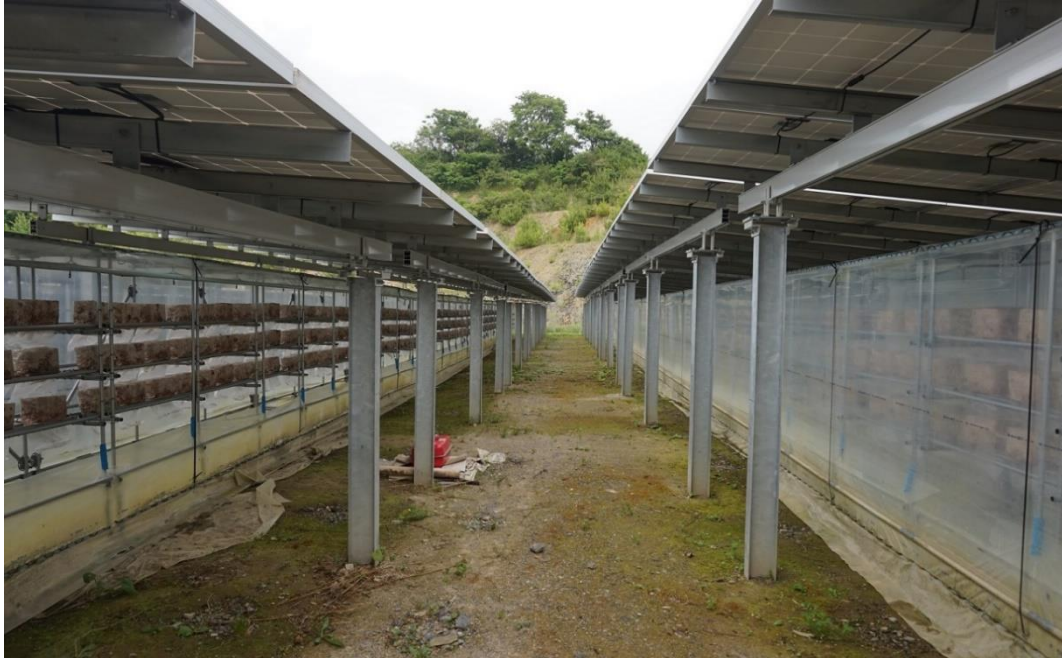
写真6◇架台の構造。太陽光パネルを地上2メートル以上に設置するため強度を高めた
