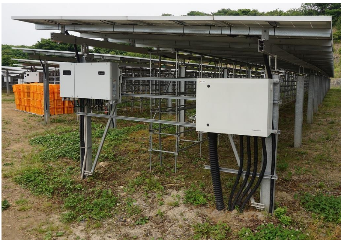
写真 8◇太陽光パネルの列ごとに小型のパワーコンディショナー（左側の装置）を設置、さらに複数の列の電力を集電箱（右側の装置）で集約した後、受変電設備から送電線へ送る
