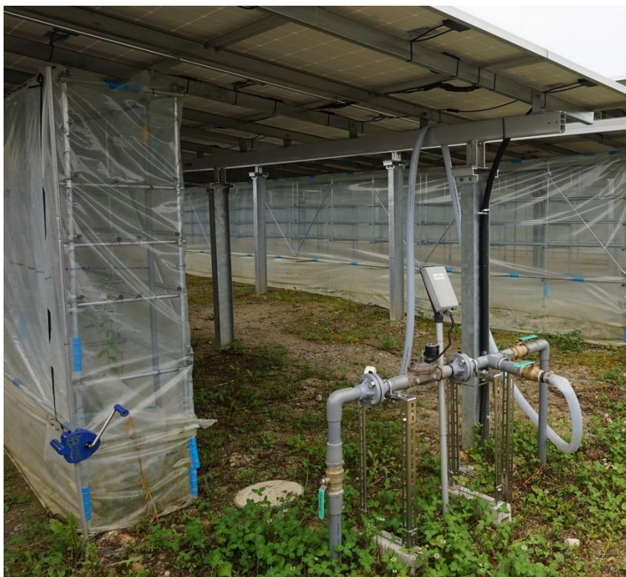
写真 11◇自動散水装置
