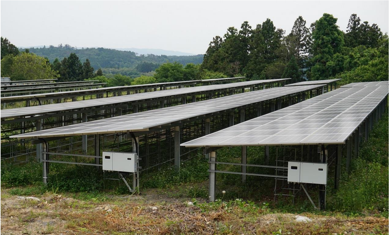
写真 5◇「登米善王寺太陽光発電所」の太陽光パネルの設置状態
